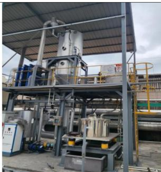
现有双效蒸发器设施
